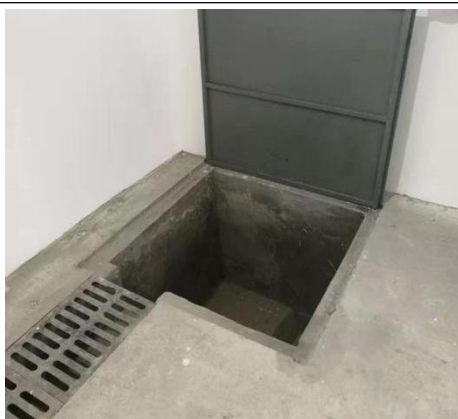
危废库地面收集沟及收集井（2m 3 ）
