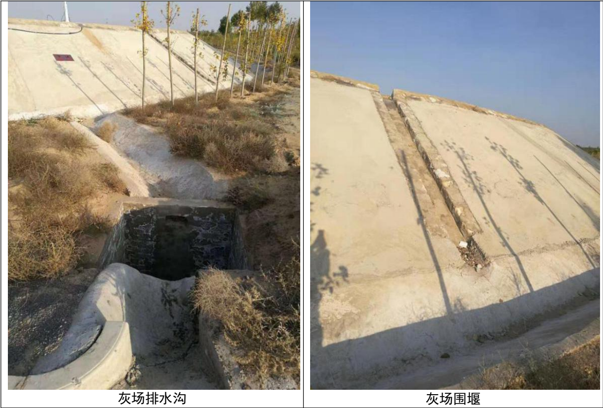
图 3.1-6 一期工程主要环保设施现状照片
